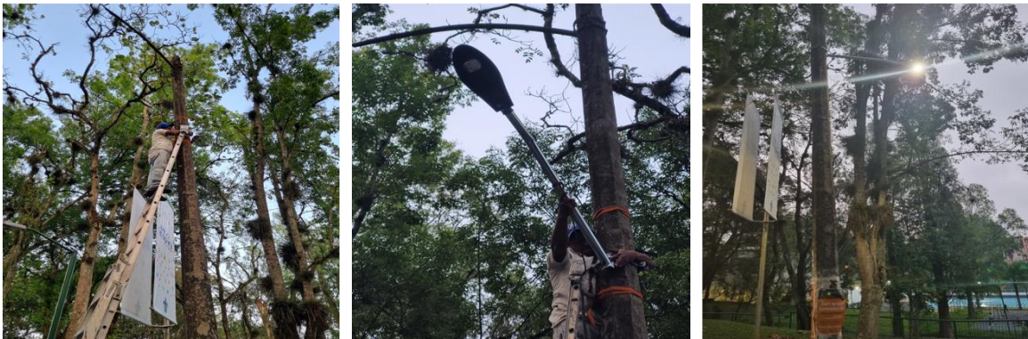
Imagen 186. Luminaria en andador del estacionamiento de empleados. Fuente: Archivo Dirección FAUV Xalapa (2024).
