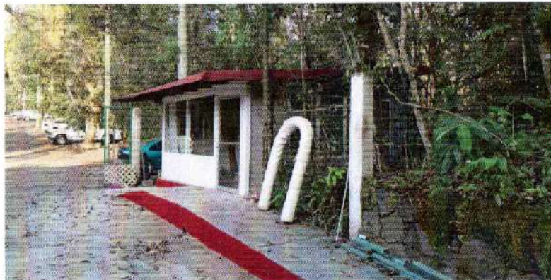
Construcción de salón de clases en el Orquidario UV, adscrito al CITRO.
