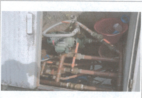
F3: Sistema actual de bombeo
