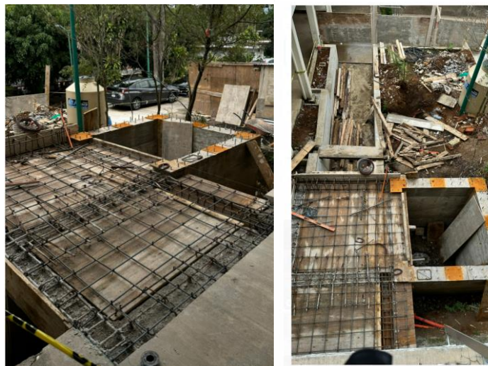
Figura 6. Construcción de Elevador para mejorar el acceso a instalaciones de la unidad Referencia: Propia
