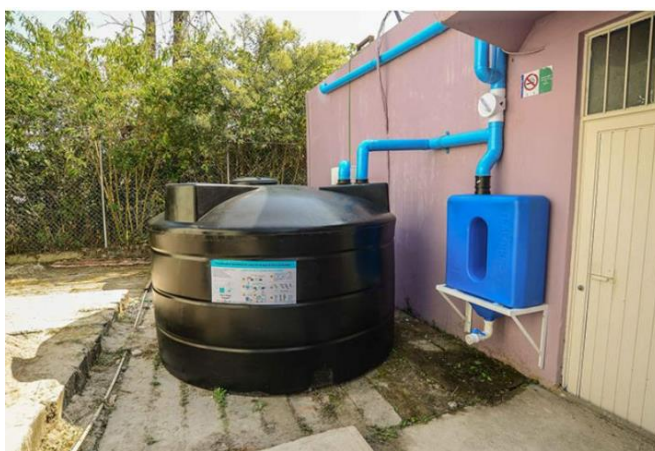
Figura 25. Sistema recolector de agua pluvial instalado en la Unidad de Ingeniería y Ciencias Químicas Referencia: Propia
