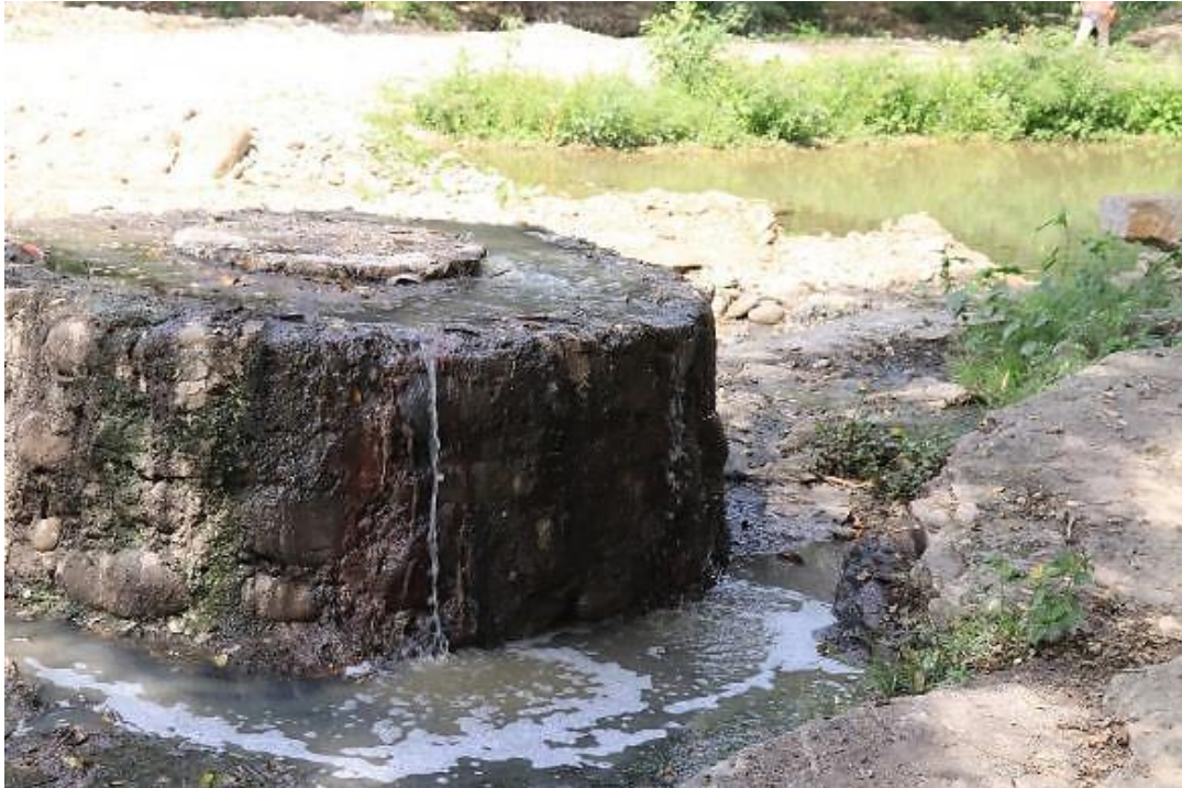
Ilustración 33. Depósito de aguas negras que se vierten directamente al río. Fuente: elaboración propia.
