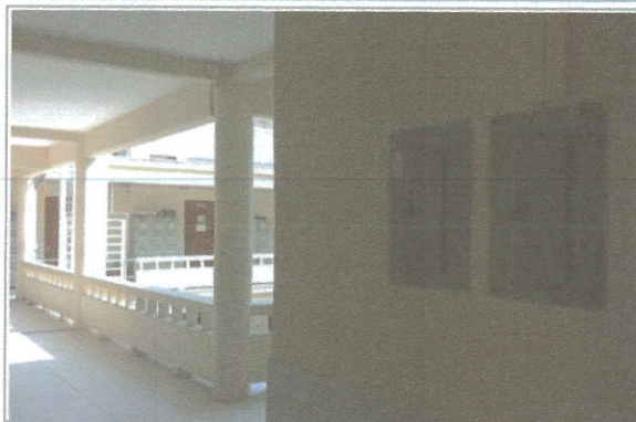
Fotografía F2: Tableros ubicados en muro de aula de primer nivel.
