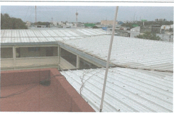
F4: Cubierta multipanel ya reparada y colocada vista desde la cubierta misma.
