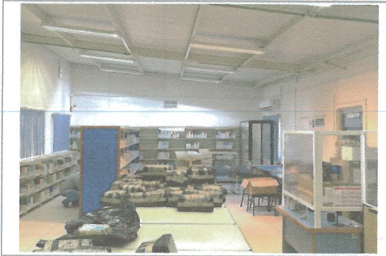
F1: Fotografía tomada desde el interior de la biblioteca donde se observa la cubierta y el piso ya terminado, se observa que la facultad ya comenzó a utilizar el área que se intervino.
