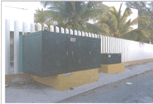
F1: Transformador y equipo de medición ya instalado y operando.
