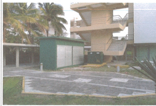
F3: Transformador y cuarto de tableros ya instalado y terminado respectivamente y operando.
