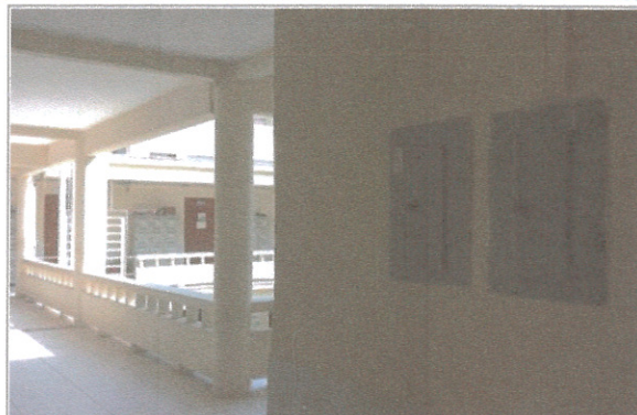
Fotografía F2: Tableros ubicados en muro de aula de primer nivel.
