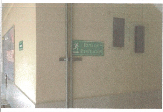
Fotografía F3: Tableros ubicados frente a escaleras del primer nivel.
