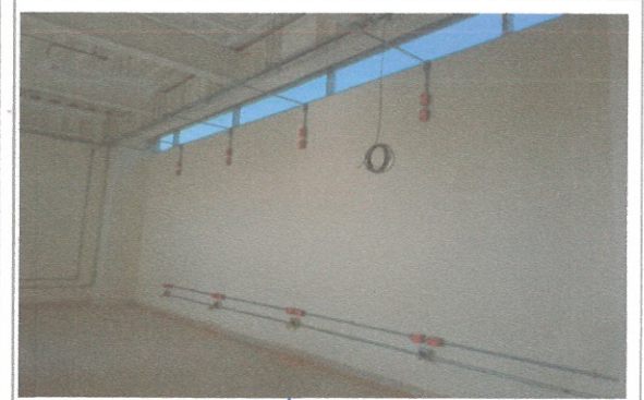
F5: Edificio C Instalación eléctrica
