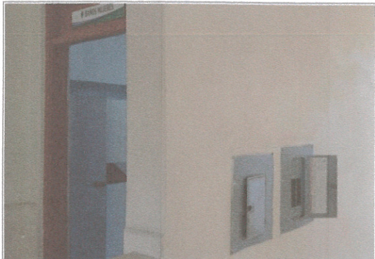
Fotografía F1: Tableros ubicados a un costado del baño de mujeres en segundo nivel.
