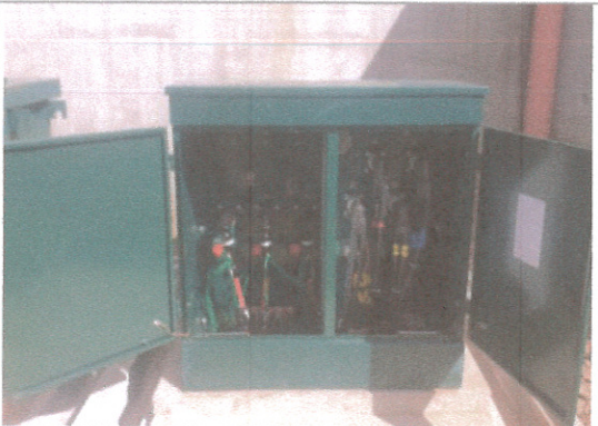
F3: Edificio (B) Transformadores
