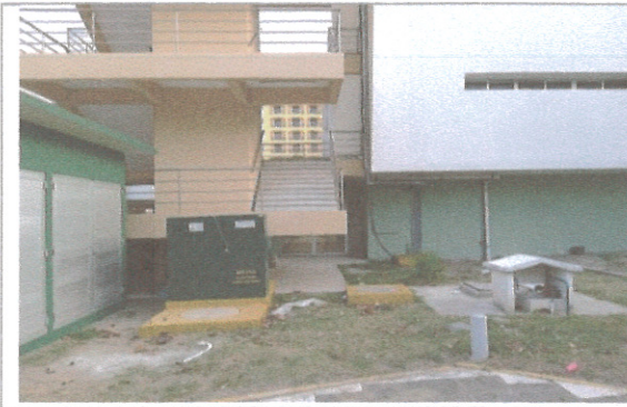
F2: Transformador y cuarto de tableros ya instalado y terminado respectivamente y operando.
