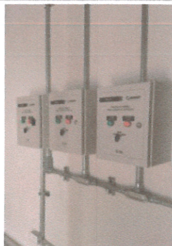
F3: Equipo de control de bombeo
