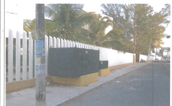
F5: Transformador y equipo de medición ya instalado y operando.
