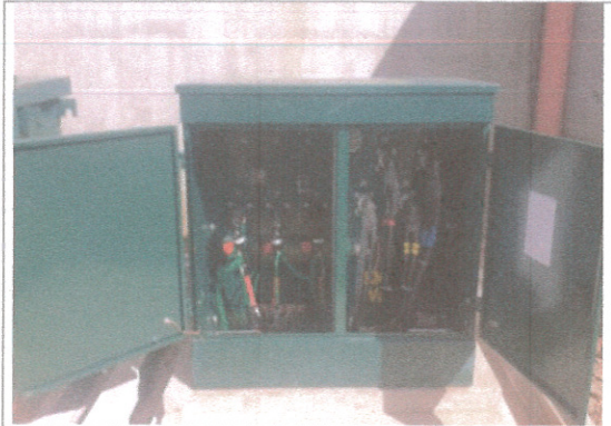
F3: Edificio (B) Transformadores
