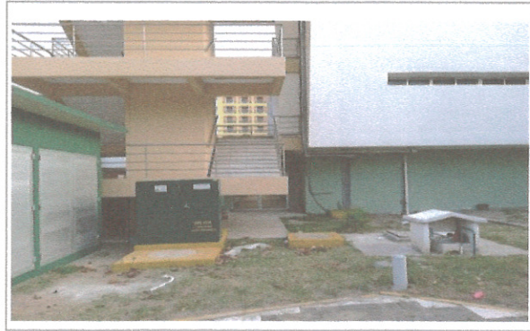
F2: Transformador y cuarto de tableros ya instalado y terminado respectivamente y operando.
