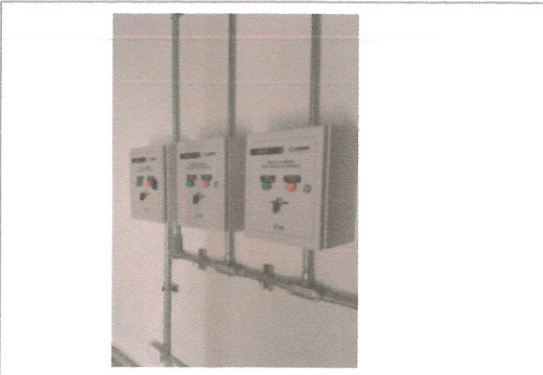
F3: Equipo de control de bombeo
