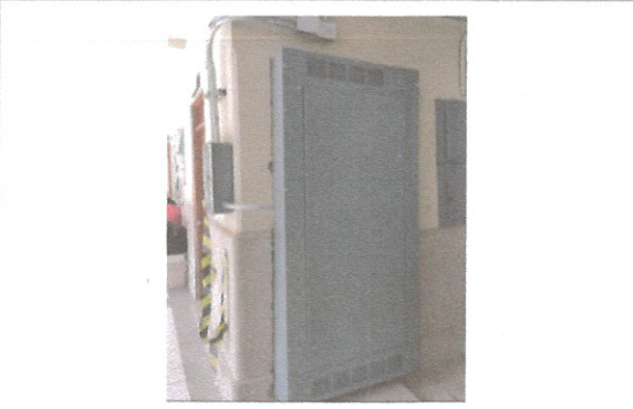
Fotografía F4: Tableros generales ubicados en planta baja.
