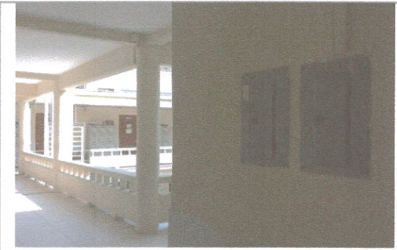
Fotografía F2: Tablero ubicados en muro de aula de primer nivel.
