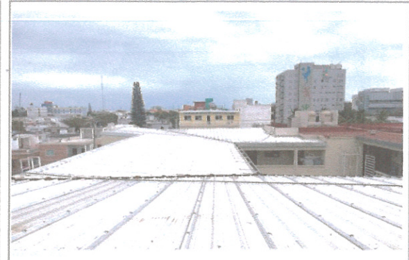
F5: Cubierta multipanel ya reparada y colocada vista desde la cubierta misma.
