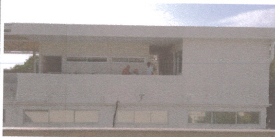
F2: Fotografía tomada desde el segundo nivel del Edificio C se observa los trabajos ya terminados.
