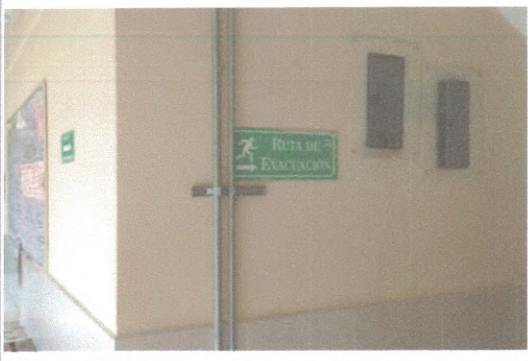
Fotografía F3: Tableros ubicados frente a escaleras del primer nivel.
