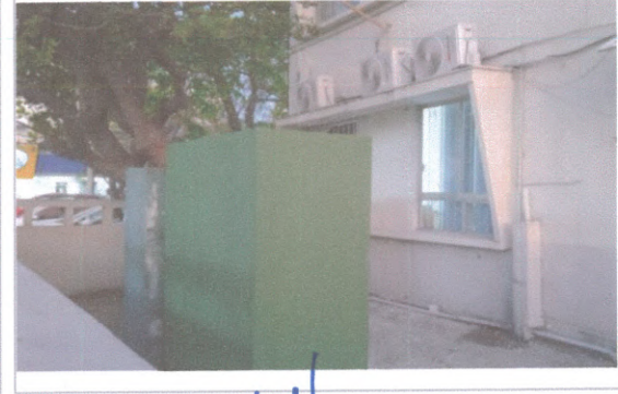
Fotografía F5: Transformador ubicado en el exterior de la facultad.
