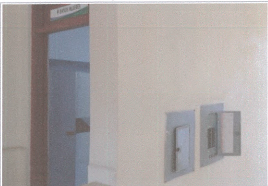
Fotografía F1: Tableros ubicados a un costado del baño de mujeres en segundo nivel.
