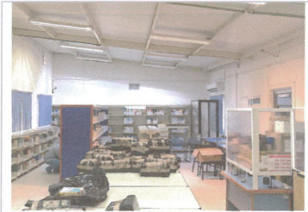
F1: Fotografía tomada desde el interior de la biblioteca donde se observa la cubierta y el piso ya terminado, se observa que la facultad ya comenzó a utilizar el área que se intervino.
