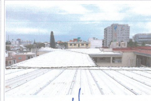
F8: Cubierta multipanel ya reparada y colocada vista desde la cubierta misma.
