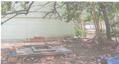
F4: Cisterna ubicada en la Facultad de Pedagogía
