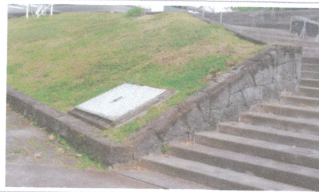
F2: Cuarto de Bombas
