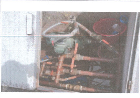
F3: Sistema actual de bombeo
