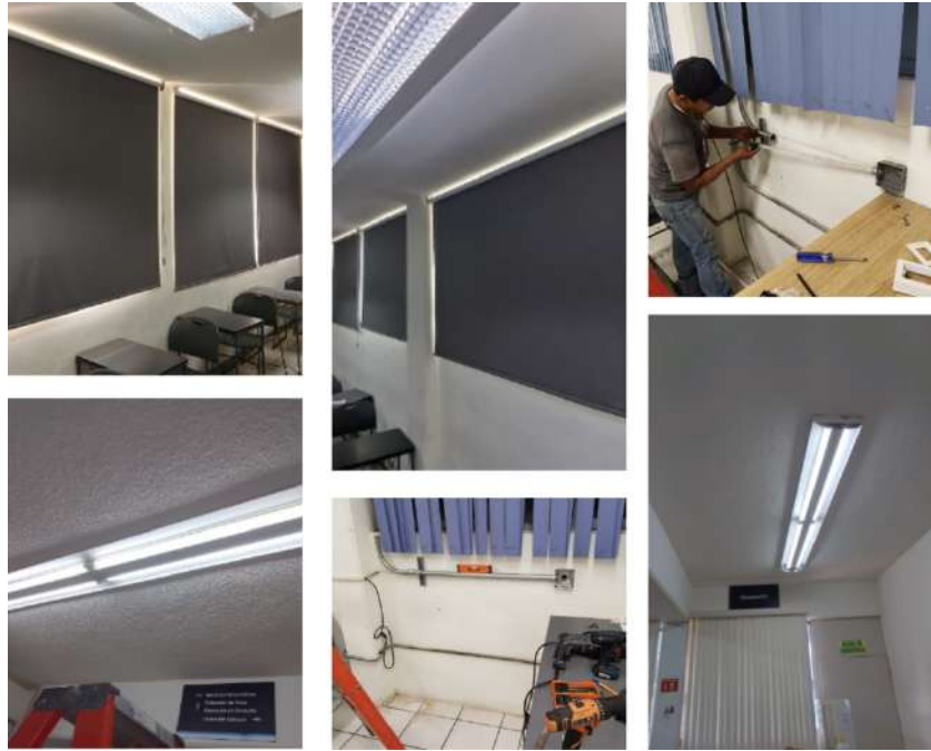
Figura 72. Instalación de contactos eléctricos y conexiones para cables HDMI en salones, Mantenimiento y cambio de nuevas luminarias LED.
