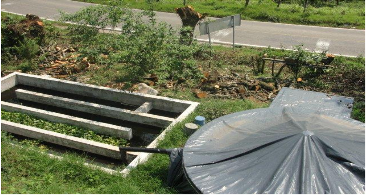
Foto 1; tanque de digestión anaerobia y canal de sedimentación
